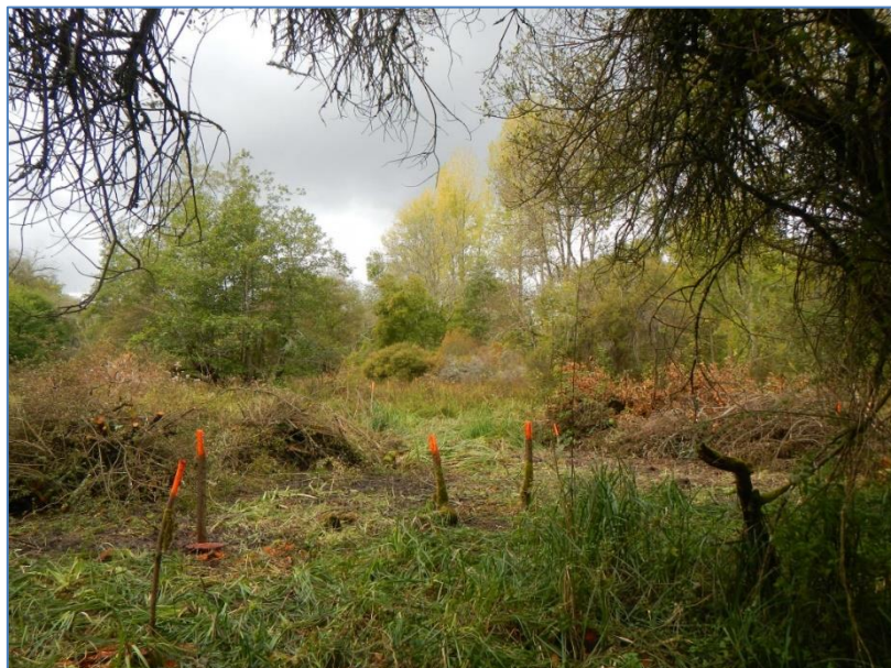
Figure 8 : Travaux sélective d'arrachage sélectif de saule en vue de la reconstitution d'une mégaphorbiaie (source : SRB Dronne)
